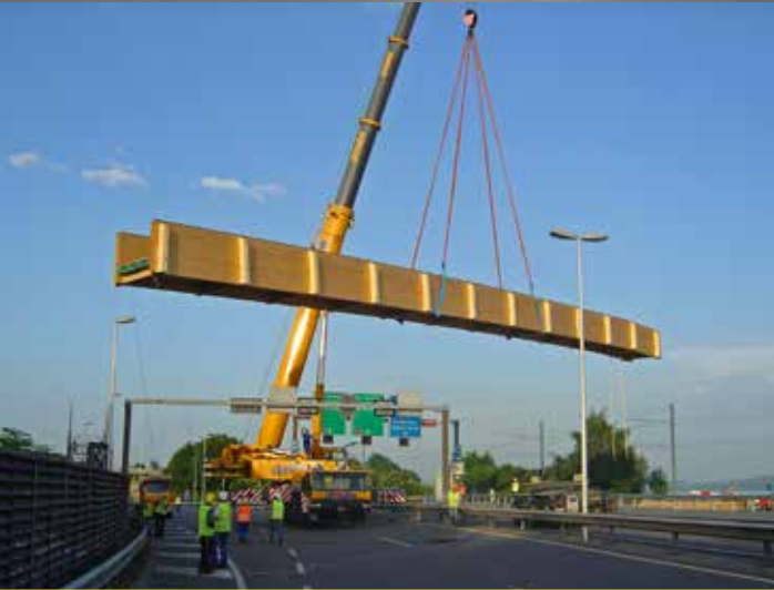
Mise en place de la passerelle provisoire, restituant l'accès piétonnier à la gare du Littorail et aux rives.
