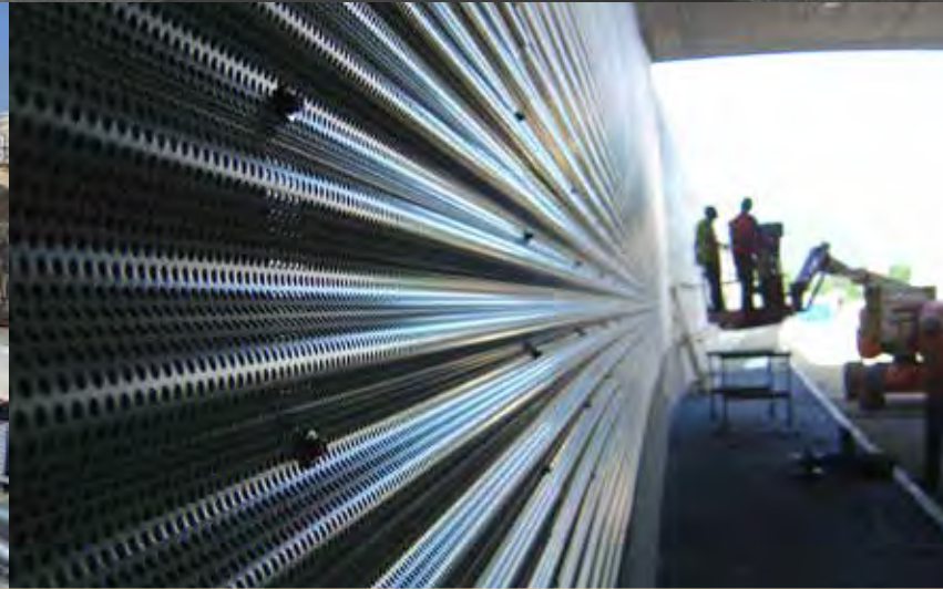
Les parois antibruit disposées sur les murs centraux n'ont qu'une épaisseur de 10 cm contrairement aux éléments antibruit des murs Nord et Sud qui font 20 cm; l'espace à disposition ne permettait pas l'uniformisation des largeurs des parois.
