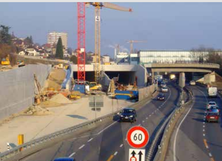
Proximité des voies en service à Auvernier: les voies en direction de Lausanne seront, dans une phase ultérieure, déviées par-dessus la tranchée de façon à pouvoir terminer la construction des murs Sud et central, ainsi que la chaussée autoroutière.
