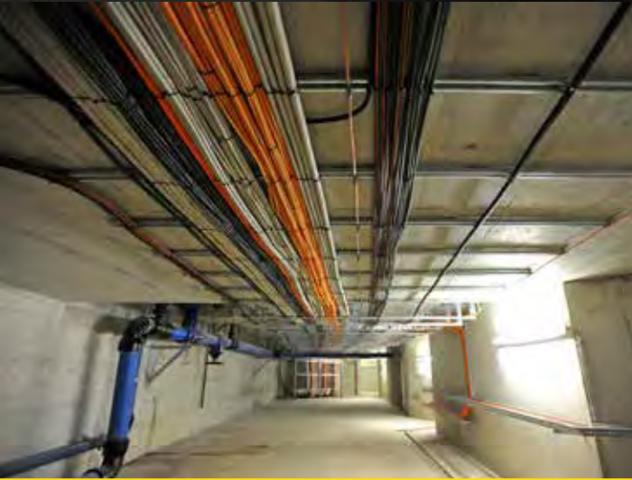
Vue du câblage et de la défense incendie dans les galeries techniques.
