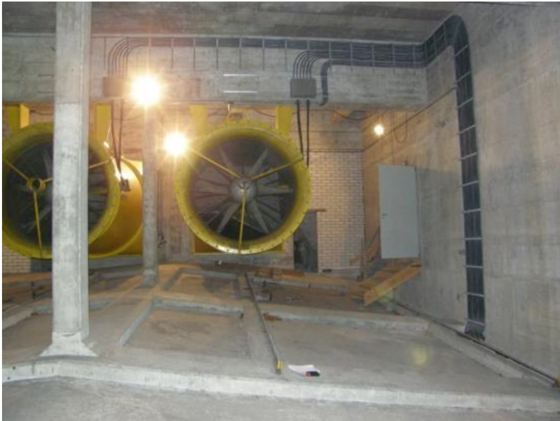
Ventilateurs d'air frais (doublés) et ventilateur unique d'extraction des fumées
