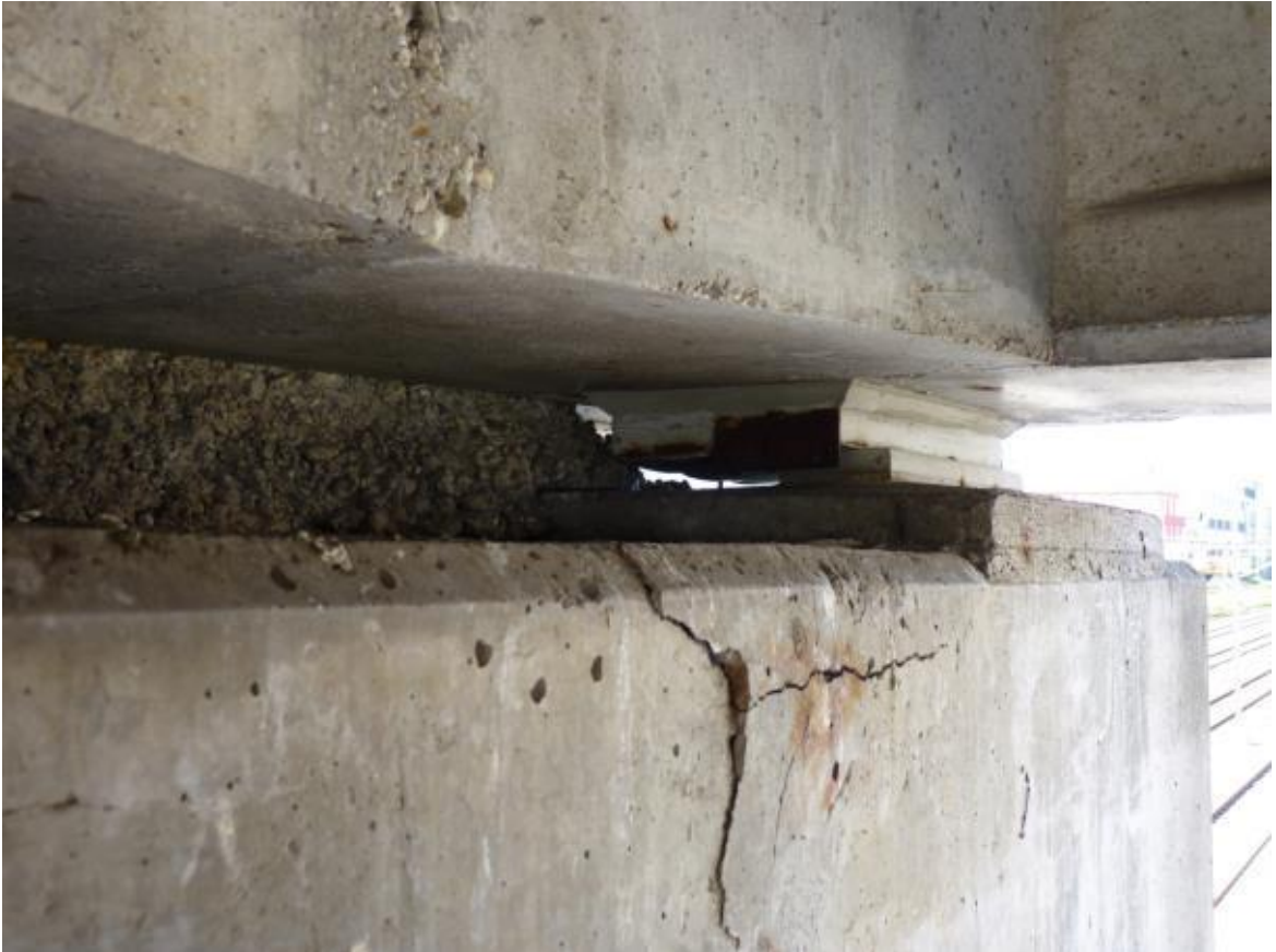
Vue d'appui de poutre sur sommier. Excentricité extrême de l'appui ne reposant que sur 30 mm.
