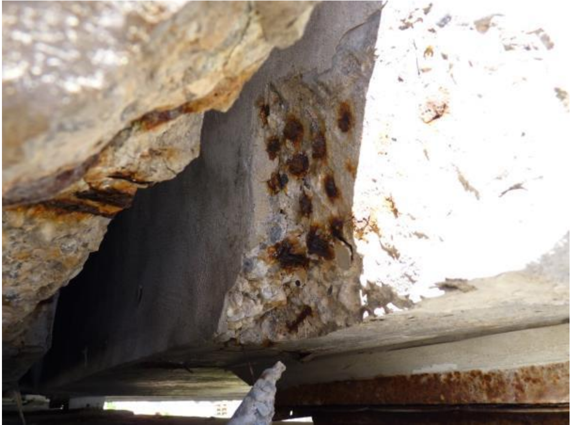
Extrémité de poutre en mauvais état.
