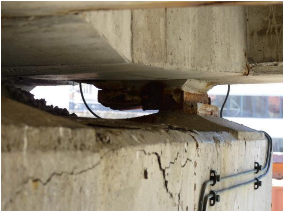
Sommier d'appui et appareil d'appui en très mauvais état. Excentricité extrême de l'appui ne reposant que sur 30 mm.
