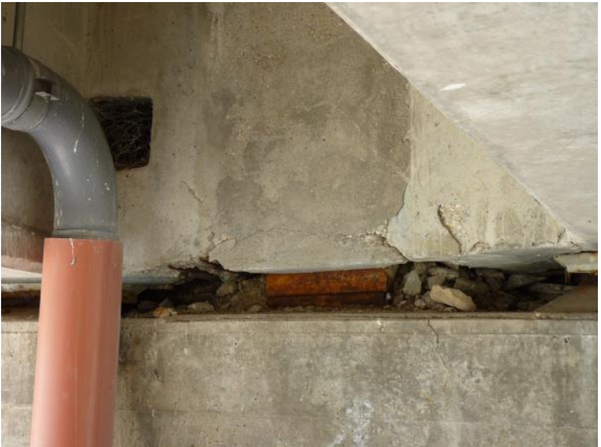
Appui fixe du pont dégradé.
