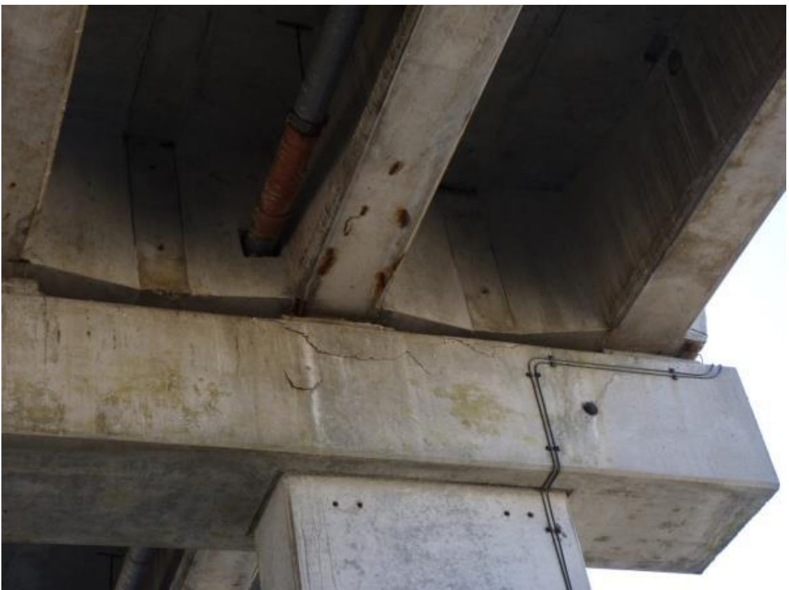
Vue de dessous. Sommier en mauvais état.
