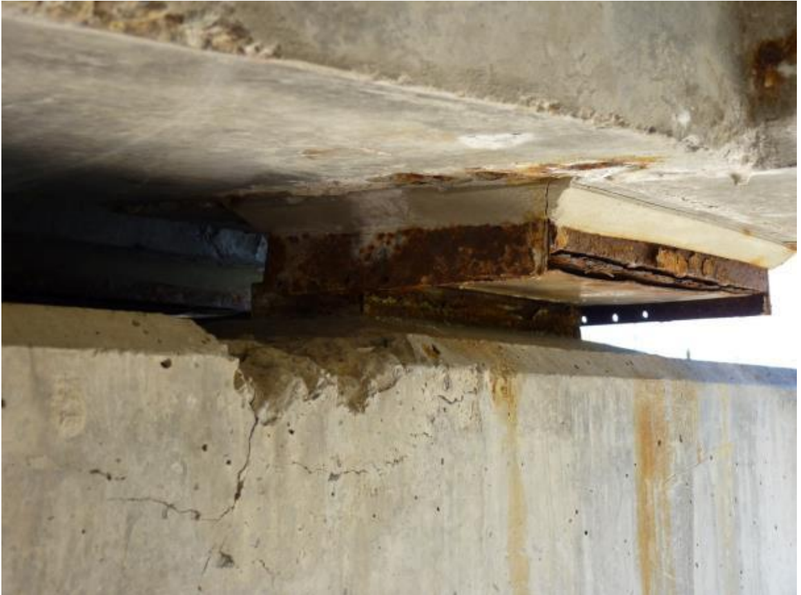
Appui existant en très mauvais état.
