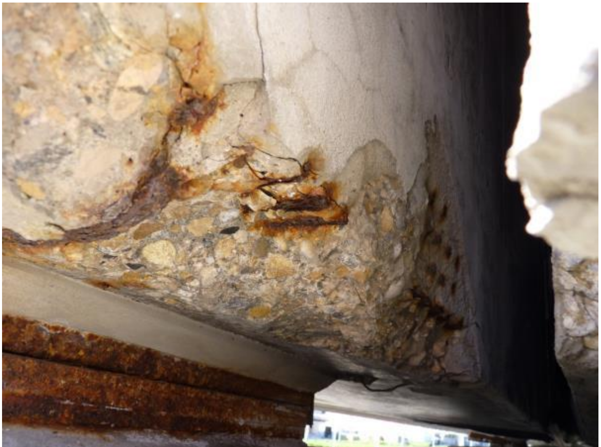
Extrémité de poutre en mauvais état, armature apparente.
