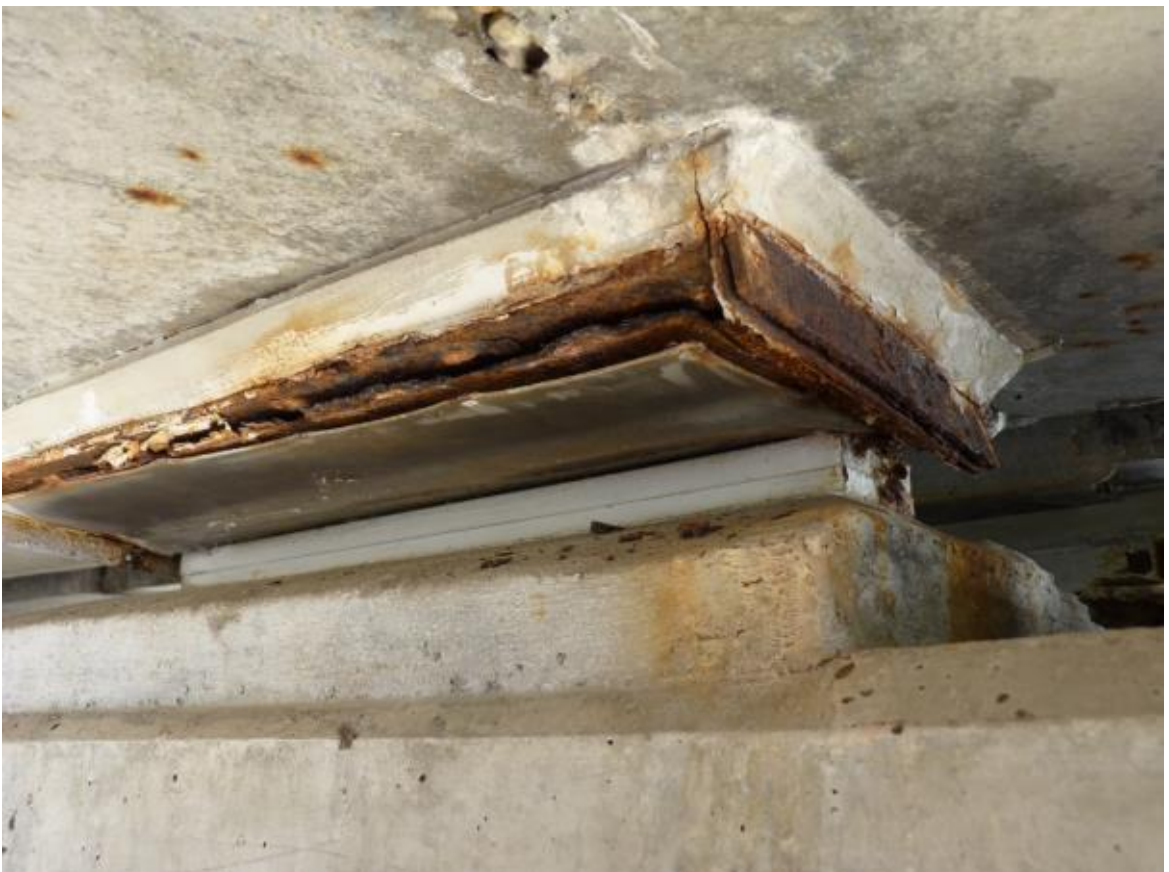
Appui en très mauvais état, complètement feuilleté.
