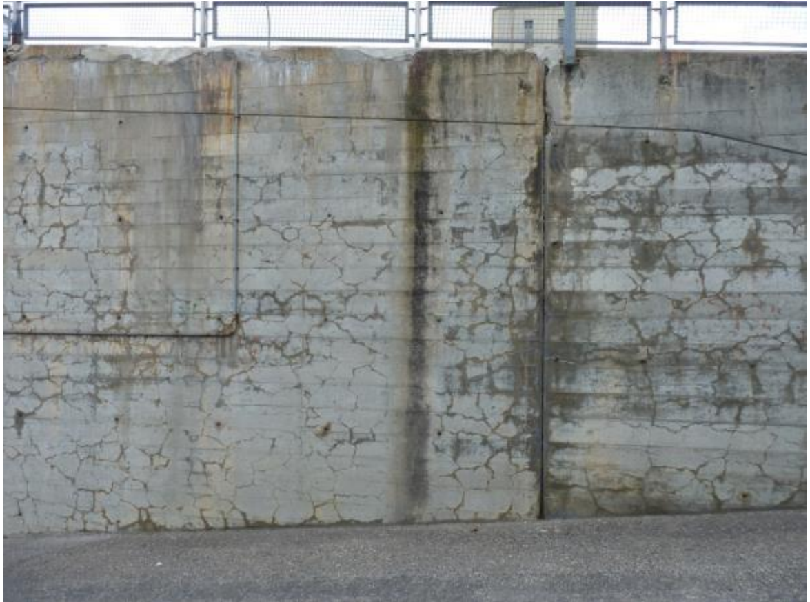
Béton culée complètement fissuré.
