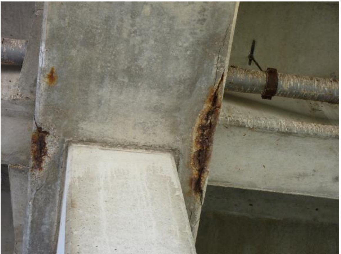
Sommier vu de dessous en mauvais état.
