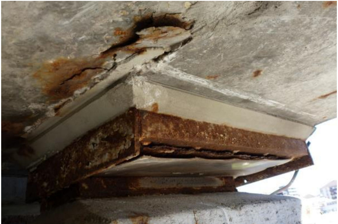
Appui en très mauvais état.
