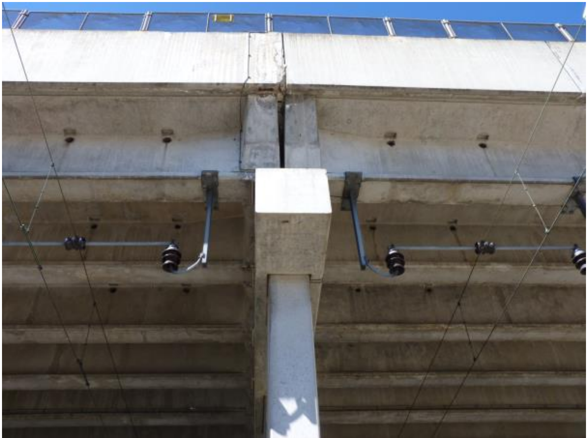
Appui très excentré des poutres sur le sommet.
