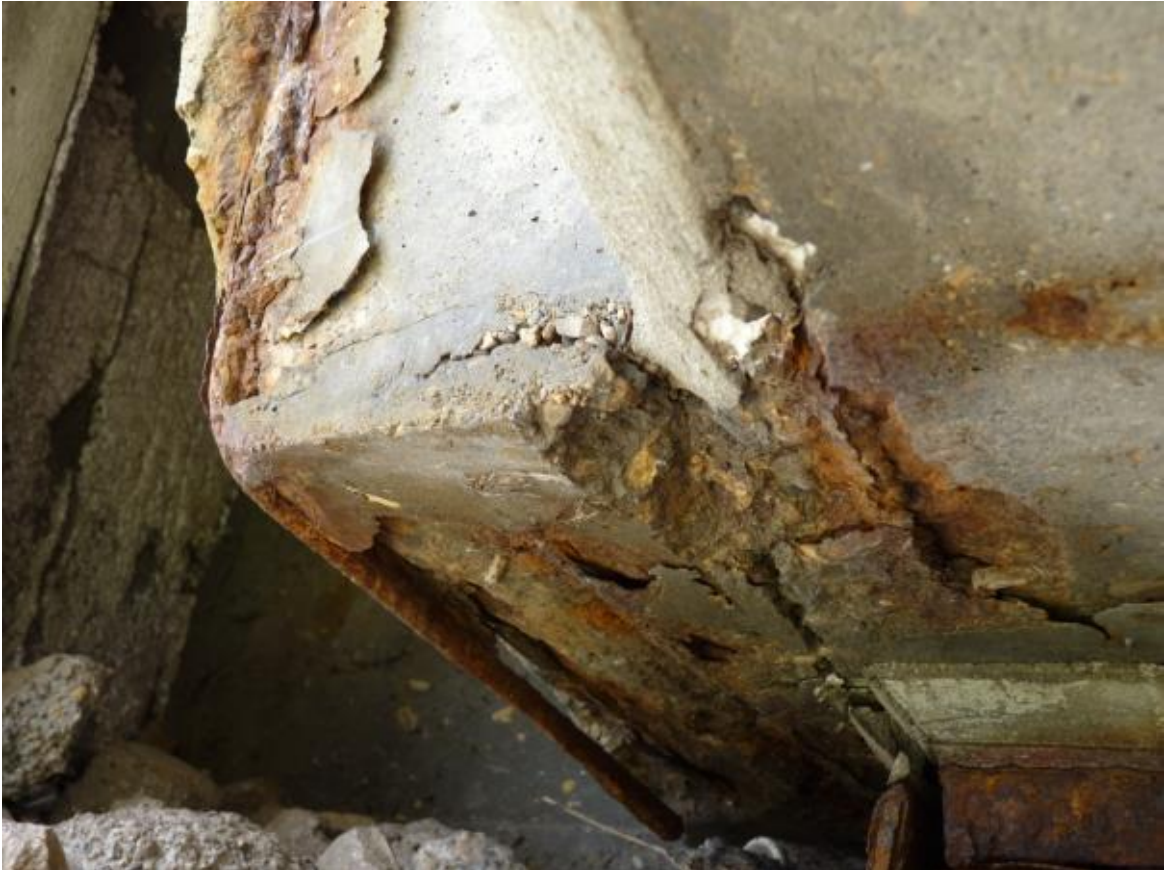
Extrémité de poutre sur appui en très mauvais état.
