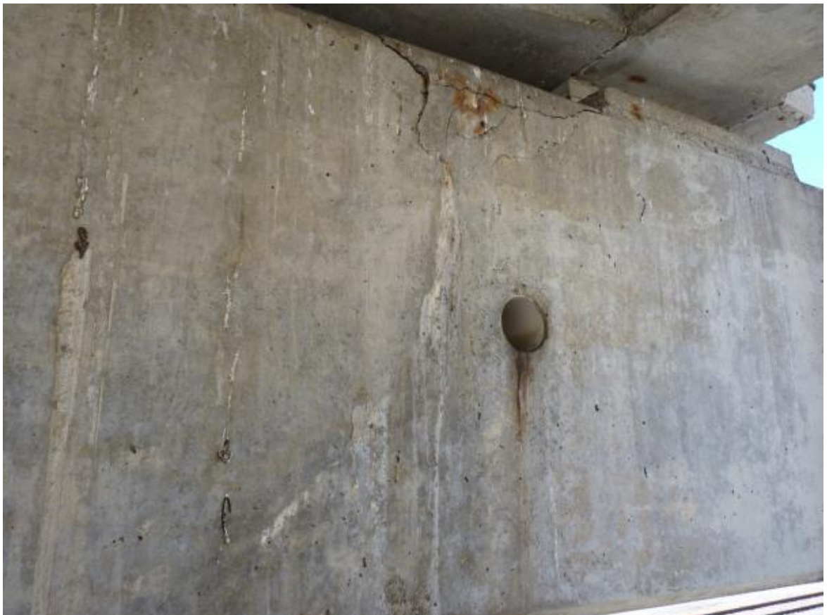
Extrémité de sommier en mauvais état.
