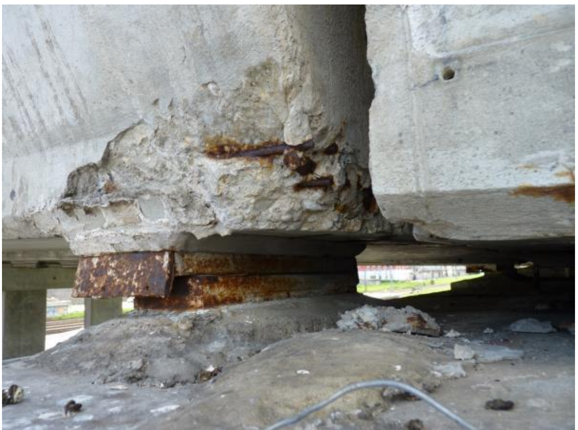
Extrémité de poutre et appui en mauvais état.
