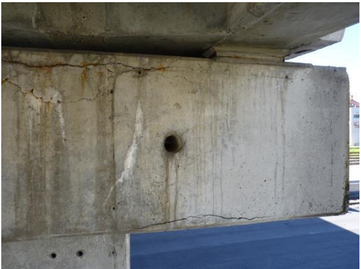
Extrémité de sommier en très mauvais état.
