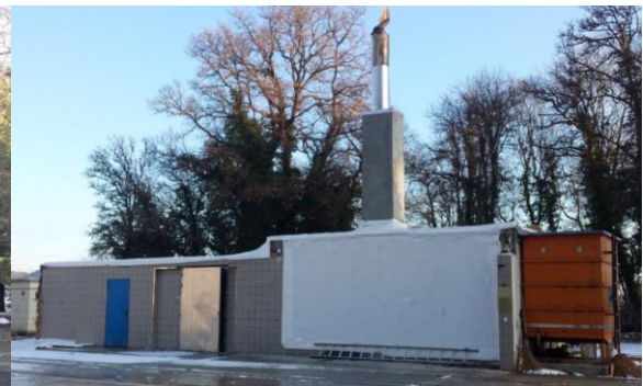
« Restes incendiés » chaufferie
