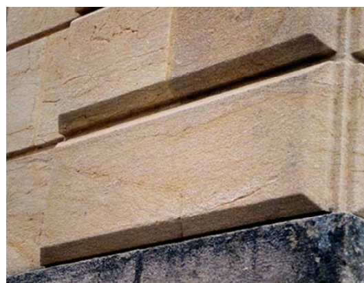
Neuchâtel, Place Numaz Droz, 3, Collège latin. L'ensemble du bâtiment a été nettoyé par une technique trop abrasive qui a effacé toute trace d'outil en mettant en évidence les hétérogénéités de la pierre jaune. Photo B. Rousset, 2002
