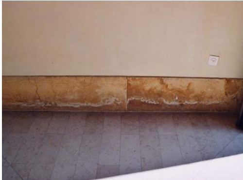
Le Landeron, entrée du temple, intérieur : effet de remontées capillaires depuis le sol où s'accumule les eaux et les sels de déverglaçage apportés par les paroissiens. Photo B. Rousset, 2002
