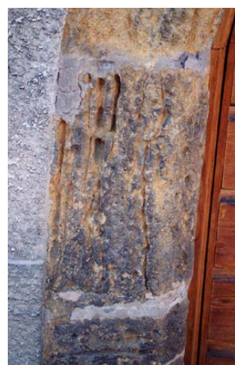
Cressier, encadrement de porte Rue Vallier, 5 : de nombreuses pierres de Cressier présentent ces formes d'altération entre l'alvéolisation, la dissolution karstique et l'érosion différentielle (cf. 2.2). Photo B. Rousset, 2002
