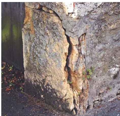
Bevaix, mur d'enceinte du parc du château : cette pierre d'angle subit un délitage intense probablement en raison du gel qui désagrège les strates les plus fines. Photo B. Rousset, 2002
