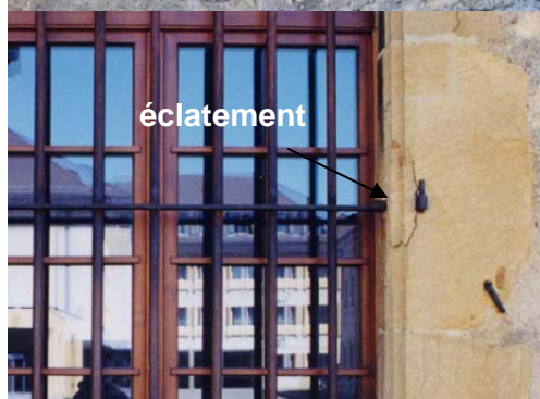
Colombier, château : le gond enchâssé trop près du bord a fait éclater la pierre. Photo B. Rousset, 2002
