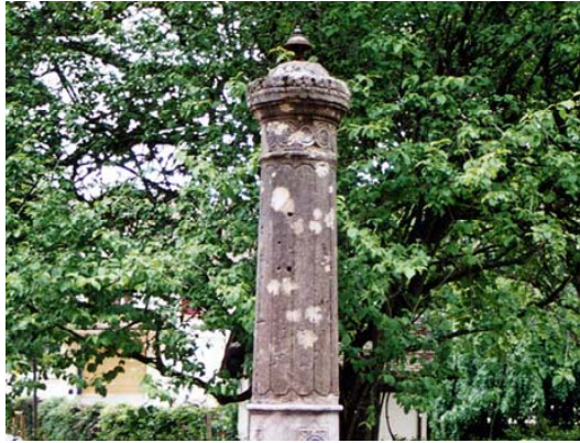
Neuchâtel, Faubourg du lac, colonne sur une fontaine : le recouvrement gris noir est dû à des algues. Photo B. Rousset, 2002
