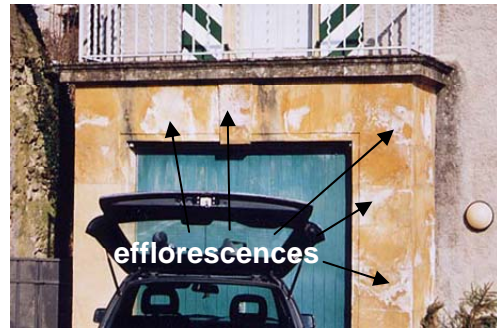
Romainmôtier : l'encadrement de porte de ce garage est recouvert d'efflorescences. Photo B. Rousset, 2002
