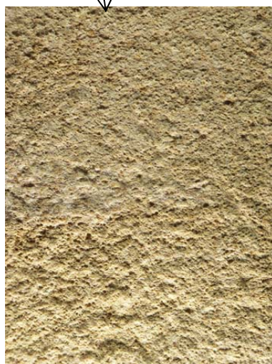
Faubourg de l'Hôpital, 18 Hydrogommage "agressif" + Traitement hydrofuge ?
