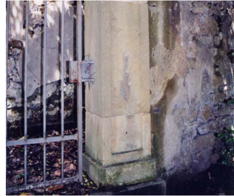
Neuchâtel, rue de l'Evole : tout ce pilier est recouvert d'un film verdâtre dû à des algues. Photo B. Rousset, 2002
