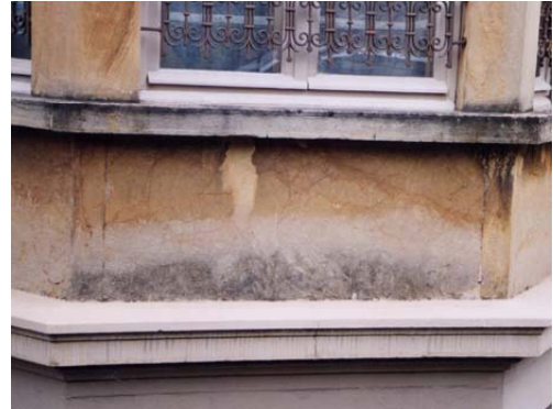
Neuchâtel, avenue de la gare, 6 : effet de remontées capillaires depuis un rebord inférieur imperméable. Photo B. Rousset, 2002
