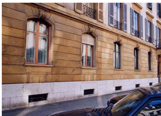
Neuchâtel, Rues des Beaux Arts, 18,20 : la partie droite du bâtiment a été nettoyée récemment tandis que la partie gauche est recouverte d'une patine. Photo B. Rousset, 2002
