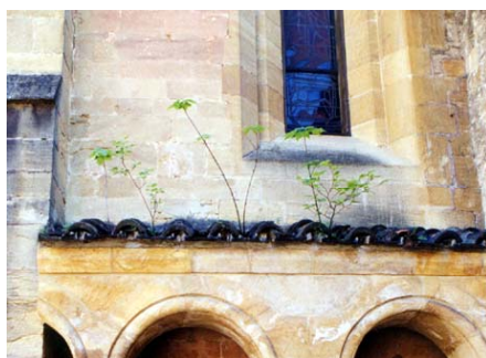
Neuchâtel, cloître de la collégiale : des arbustes se sont développés sur le toit en tuiles mais leurs racines risquent d'atteindre la pierre sous-jacente et de déceler des blocs. Photo B. Rousset, 2002
