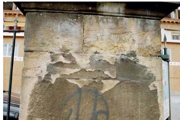
Neuchâtel, Rue de la Maladière, 45, Portail de l'hôpital Pourtalès : La croûte noire gypseuse développée sur ce pilier, s'épaissit de bas en haut en raison de l'augmentation de la protection du chapiteau. Vers le sommet, la cristallisation intense des sels sous la croûte provoque sont décollement du substrat. Photo B. Rousset, 2002
