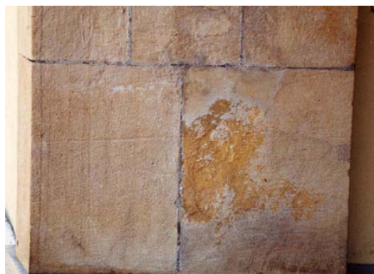
Neuchâtel, Rue Jeanne de Hochberg, face à la Tour des Prisons : par endroit, le produit antigraffiti, très épais, s'écaille apparemment sans dommage pour la pierre. Photo B. Rousset, 2002
