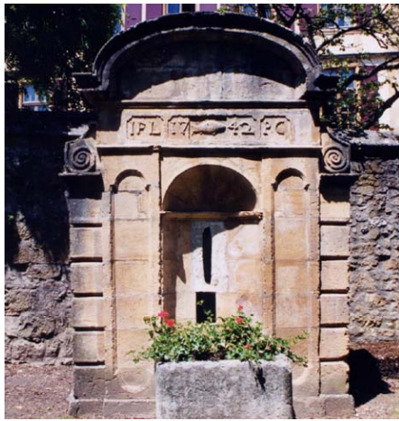
Auvernier, ancienne fontaine devant le château : la présence de sels hygroscopiques dans la pierre jaune se traduit par la présence d'efflorescences (voiles blancs) et de taches humides (pierre plus sombre à droite). Photo B. Rousset, 2002
