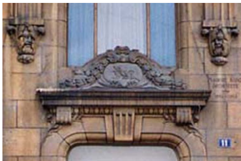
Neuchâtel, Faubourg du Lac, 11 : cet élément décoratif sous abri est couvert de poussière. Photo B. Rousset, 2002
