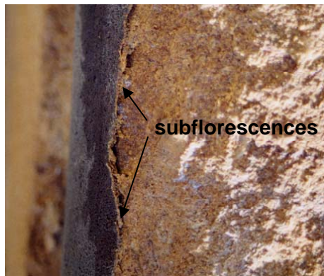
Neuchâtel, partie romane du château : des cristallisations de sels (aiguilles blanchâtres) se développent sous la surface et décollent progressivement la croûte. Photo B. Rousset, 2002
