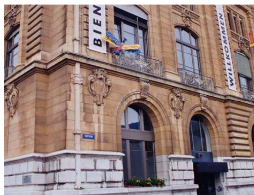
Neuchâtel, Place du Port, 2 : le bâtiment est couvert d'une patine plus ou moins épaisse, excepté sur les parties régulièrement lessivées par les pluies. Photo B. Rousset, 2002
