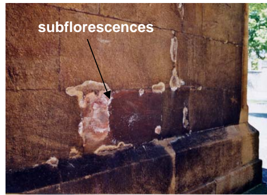
Neuchâtel, portail de la collégiale : sous les croûtes se développent des subflorescences qui après la chute de la partie superficielle deviennent des efflorescences. Photo B. Rousset, 2002
