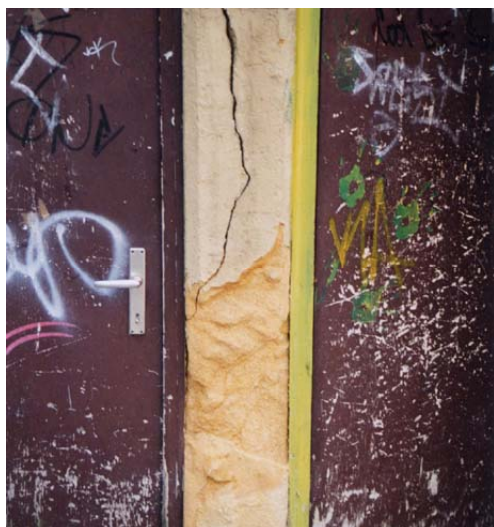
Neuchâtel, rue du Château : un véhicule a probablement percuté ce mur, entraînant une fissure et un éclat. Photo B. Rousset, 2002
