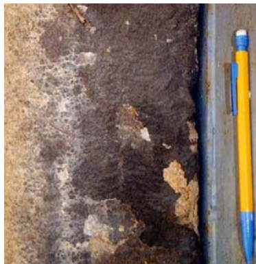
Neuchâtel, Rue Jeanne de Hochberg. Développement d'une croûte noire gypseuse en zone abritée sur un encadrement de porte. La croûte est pustuleuse en raison du développement des cristaux de gypse. Photo B. Rousset, 2002
