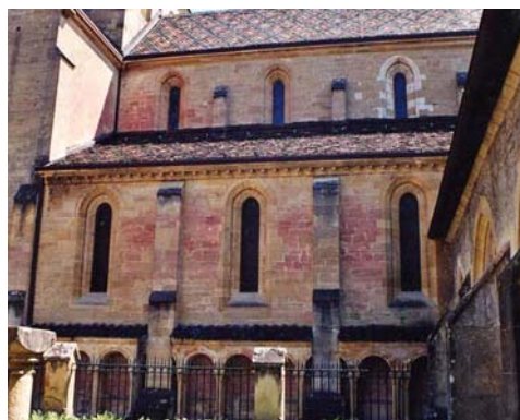
Neuchâtel, façade ouest de la collégiale (vue du cloître) : de nombreuses pierres sont rubéfiées. Photo B. Rousset, 2002
