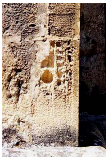
Neuchâtel, contrefort de la façade est de la collégiale : la présence de sels associée à un apport d'eau important pendant un certain temps a donné naissance à une érosion par alvéolisation. Photo B. Rousset, 2002
