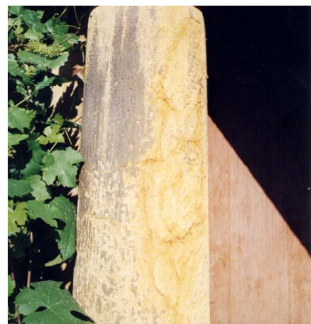
St-Blaise, chemin de la petite France : ce pilier soutenant un balcon se délite. Photo B. Rousset, 2002
