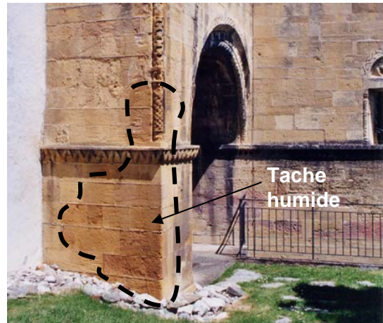
Neuchâtel, partie romane du château : cette tache humide est visible même en période sèche. Photo B. Rousset, 2002
