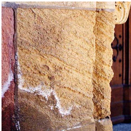
Neuchâtel, portail sud de la collégiale : la décohésion des grains due à des cristallisations de sels est plus conséquente dans les lamines les plus fragiles qui se retrouvent en retrait par rapport à la surface, laissant les lamines plus cohérentes en relief. Photo B. Rousset, 2002
