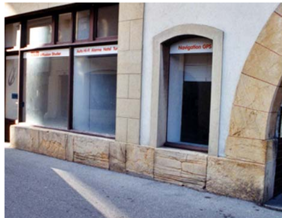
St-Blaise, Grand rue, 21. Les cycles imbibition-séchage et gel-dégel provoquent la décohésion des grains de la pierre jaune de ce soubassement. La décohésion est plus forte le long des strates les plus fragiles qui se retrouvent en retrait par rapport à la surface d'origine. Photo B. Rousset, 2002
