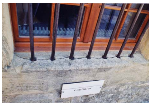
Colombier, château : l'oxydation des barreaux de fer a provoqué l'éclatement de la Pierre jaune. Photo B. Rousset, 2002
