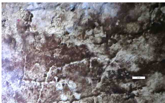
Figure 13. Taches brunes sur la paroi Ouest (cliché : Y. Delamadeleine)
