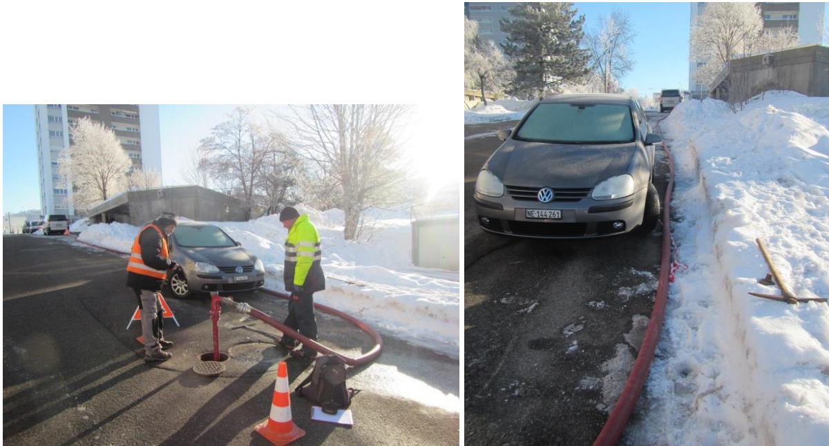
Photos : Branchement à l'hydrant de la rue du Chalet et les 120 m de coursives déroulées jusqu'au piézo, situé derrière la tour.
