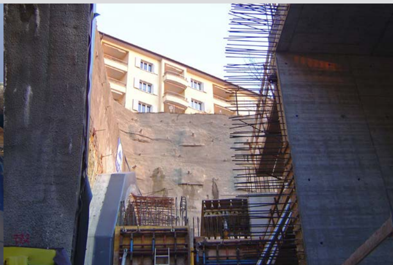
A Serrières, la liaison entre le tunnel et la tranchée est bétonnée au pied des immeubles.
