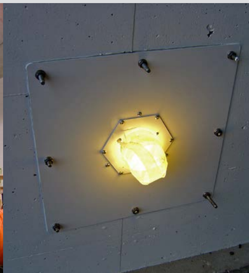
Balisage de fuite ne s'allumant qu'en cas d'incidents dans les tunnels.
