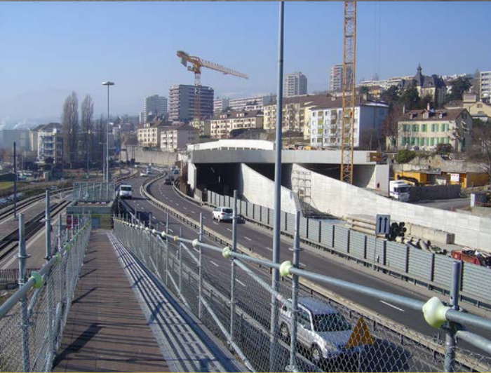
Le tram est déplacé au Sud de la gare TransN, sur le remblai provisoire du port, permettant la déviation des voies autoroutières. Leur largeur réduite est dictée par l'espace entre la gare et le mur de la tranchée.
