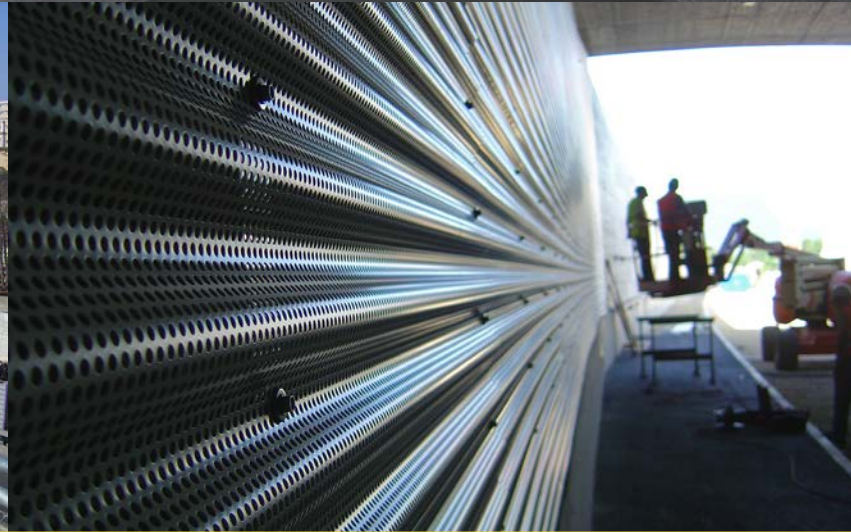
Les parois antibruit disposées sur les murs centraux n'ont qu'une épaisseur de 10 cm contrairement aux éléments antibruit des murs Nord et Sud qui font 20 cm; l'espace à disposition ne permettait pas l'uniformisation des largeurs des parois.
