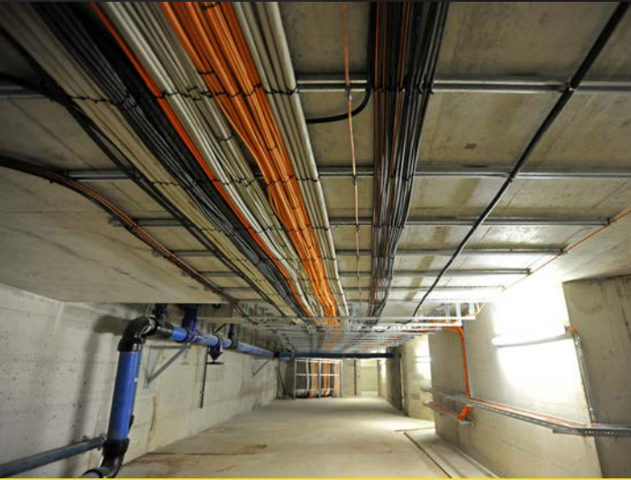
Vue du câblage et de la défense incendie dans les galeries techniques.
