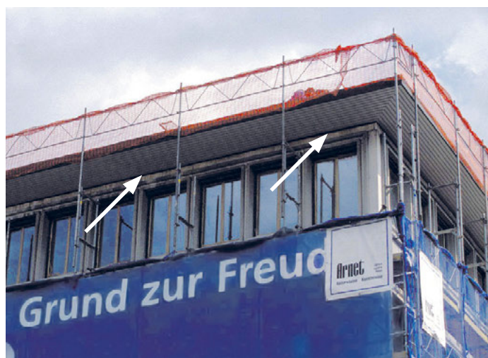
Échafaudage perméable aux Martinets. Les travaux sur le fond du berceau ont été terminés à temps.
