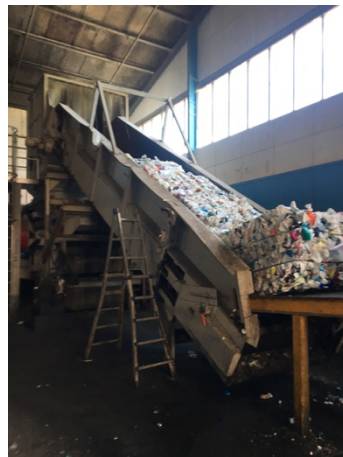
Entrée de la chaîne de broyage et lavage
