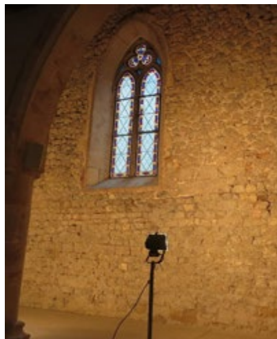
© Vue de la nef décrépie du temple de Môtiers / C. de Reynier, OPAN, mars 2021.
