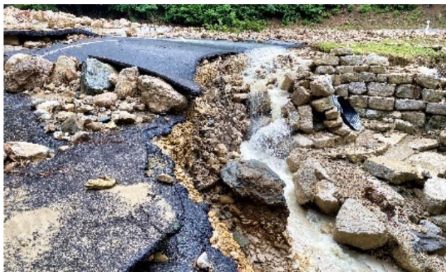
Crue avec charriage à Cressier, 2021
