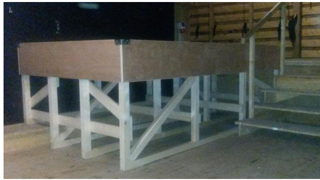
Plateforme d'entreposage pour un piano, dans la Grange au concert
