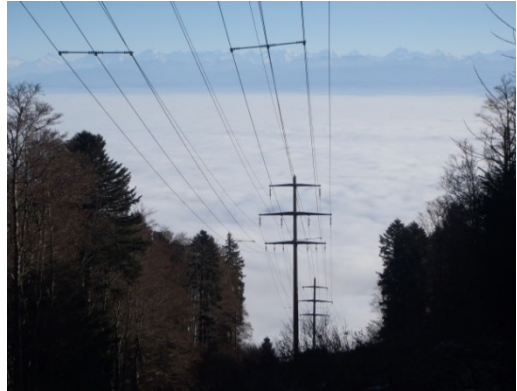
Ligne électrique (Source : SFFN, 19.12.2016)
