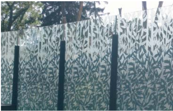
Paroi antibruit: efficace malgré le motif végétal.
