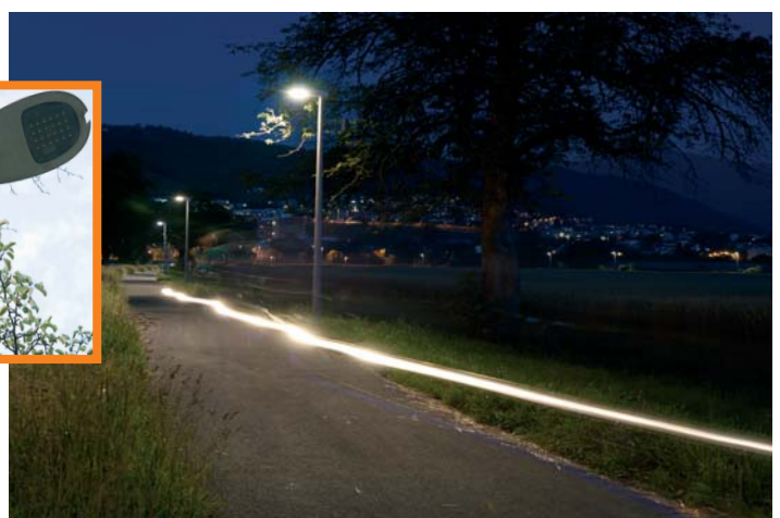
Un chemin pour piétons et vélos équipé des luminaires les plus modernes couplés à des détecteurs de mouvement. La lumière devient plus intense au passage d'un cycliste.
